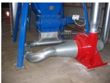
Sluse, retur rørsystem og transportventilator.
